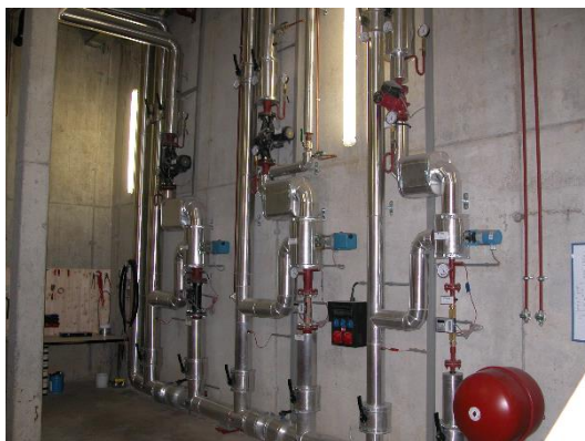
Hydraulische Regelkreise im Kesselhaus
