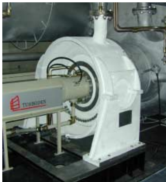
Abbildung 8: Bild der Axialturbine - Biomasse-Heizkraftwerk Holzindustrie STIA / Admont Erläuterungen: Datenquelle [6]
