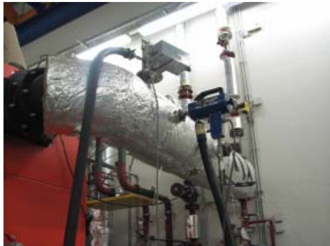
Gasprobenahme während eines Testlaufs an einer Biomasse-Versuchsfeuerungsanlage
