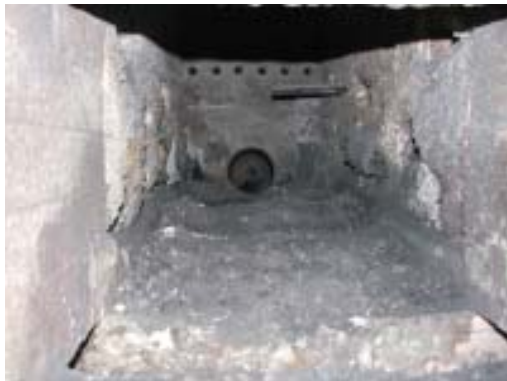
Schlackenablagerungen bei der Verbrennung halmgutartiger Biomasse
