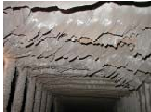
Depositionen an Überhitzerbündeln einer altholzbeheizten Dampfkesselanlage
