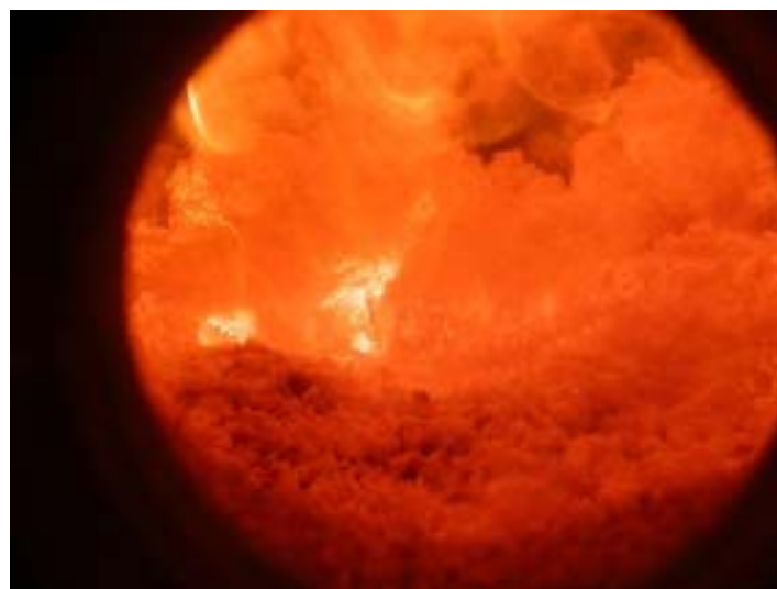
Blick in den Feuerraum an der Pilot-Rostfeuerung während Verbrennungstests mit einem „neuen“ Biomassebrennstoff im Zuge der Feuerungsanlagenentwicklung
